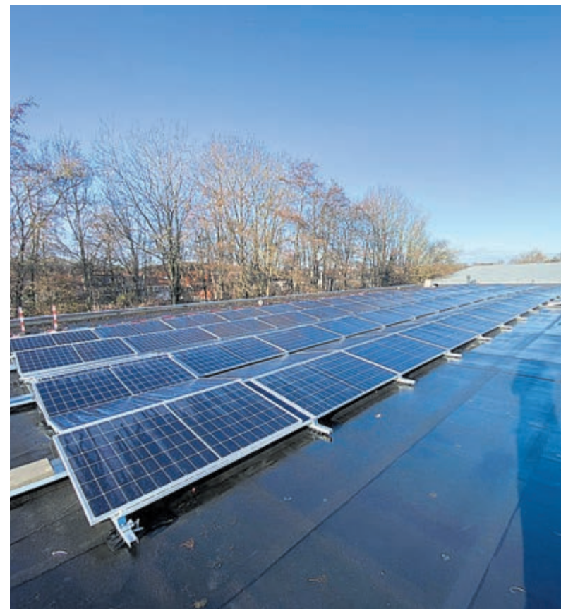
Met de door DS Energy geplaatste 164 zonnepanelen op het dak is Full of Life nu zelfvoorzienend op het gebied van elektriciteit. Foto: aangeleverd
