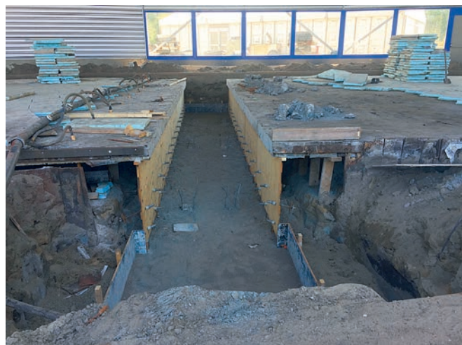
Een van headerputten in de Alkmaarse ijsbaan
